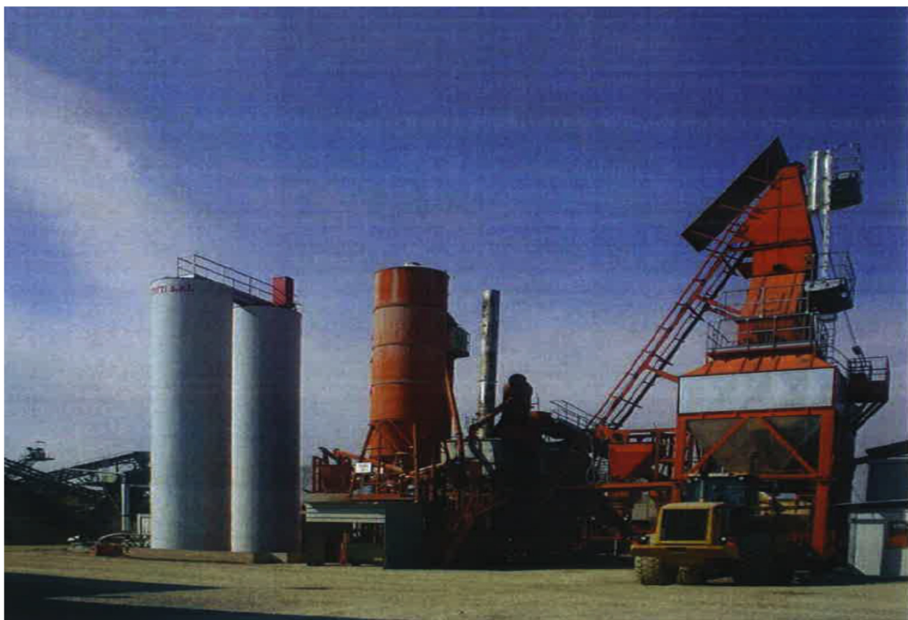
Figura 1: Impianto Ecoasfalti sito di Cusago
